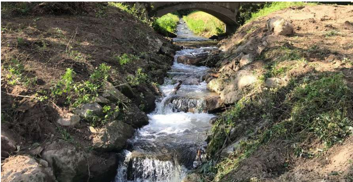
Abbildung 1: Künstliche Abstürze zwischen Brücke und Mündung in die Thur, kurz vor Beginn der Bauarbeiten.
